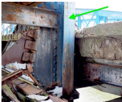
Fixare consolă prin secționare talpă montanț console situate în apropierea pilei centrale
