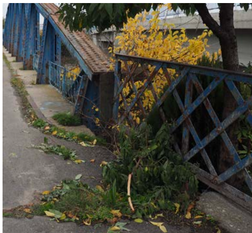
Module de balustradă montate în mod improvizat la capătul podului dinspre noul pod de beton
